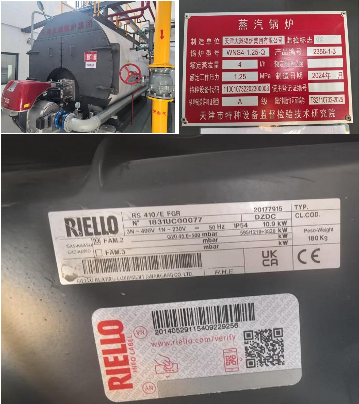
1#锅炉及低氮燃烧器
