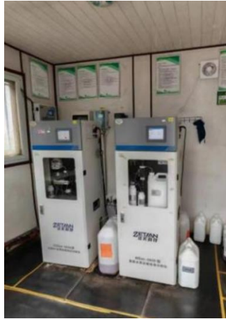
污水处理站在线装置
