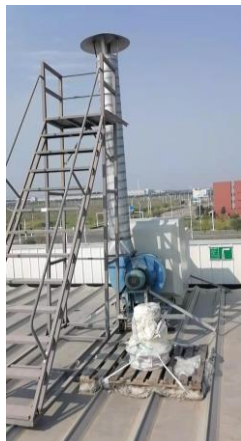
排气筒 P1 (DA001) 采样平台
