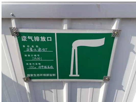
排气筒 P1 (DA001) 环保标识牌
