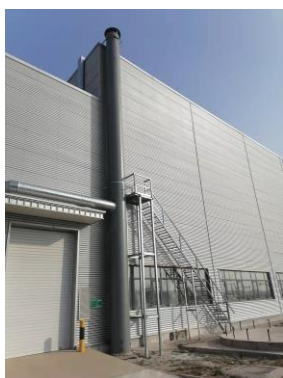
排气筒 P2 (DA002) 采样平台
