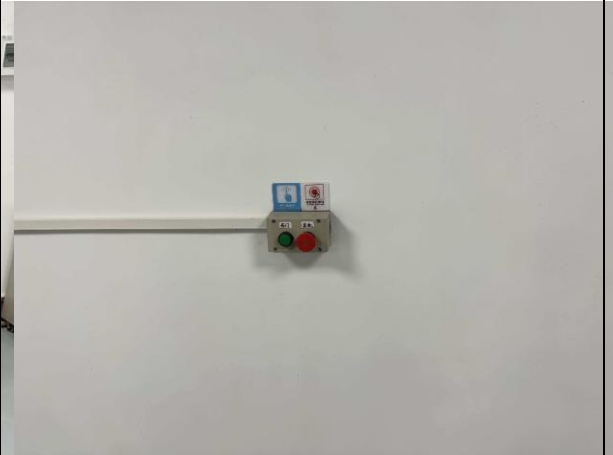
探伤室内紧急停机按钮和紧急开门开关
