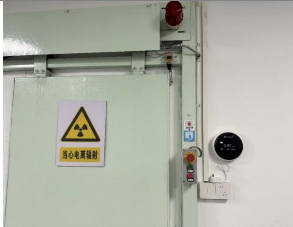
探伤室外紧急停机按钮和紧急开门开关
