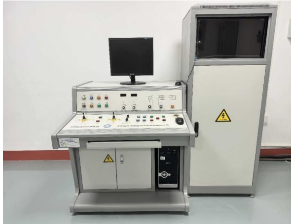
操作台钥匙控制、紧急停机按钮
