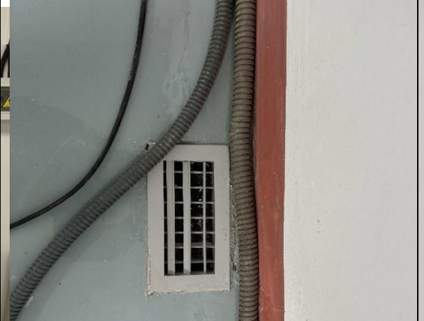
机械排风装置
