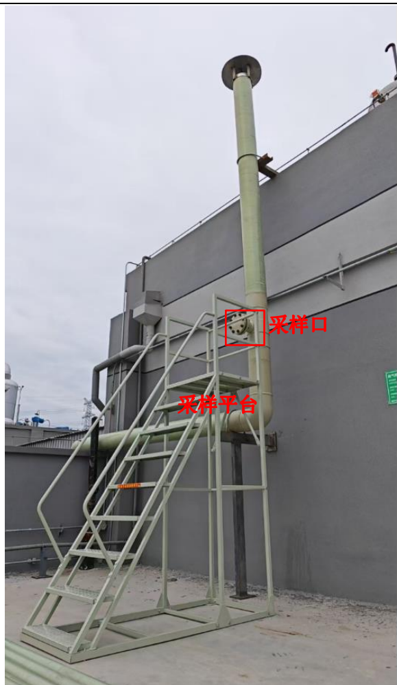
排气筒整体照片(管径 0.15m,采样口距弯头大于 0.6m)
