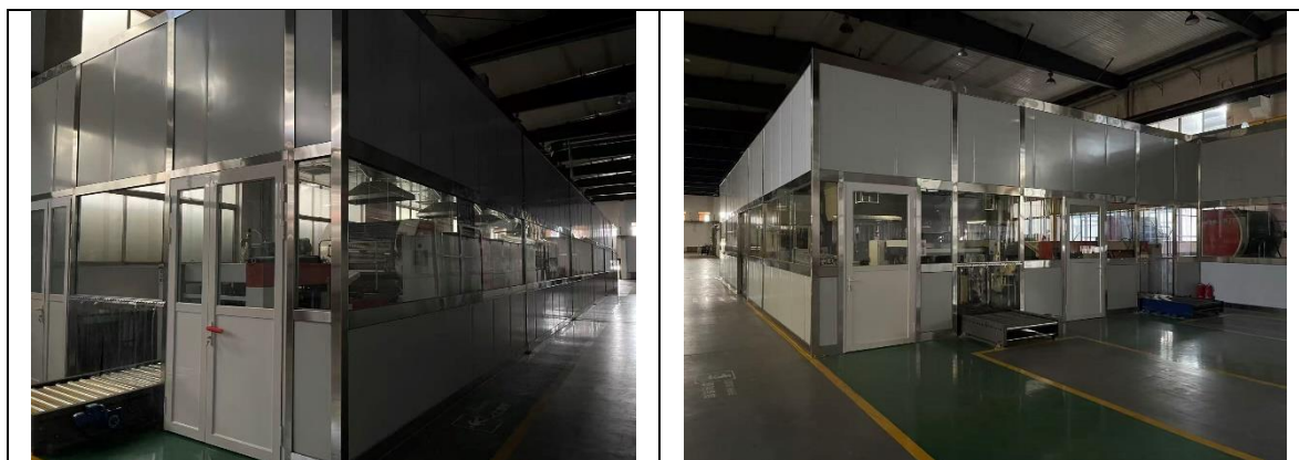
涂布线、印刷线整体负压收集
