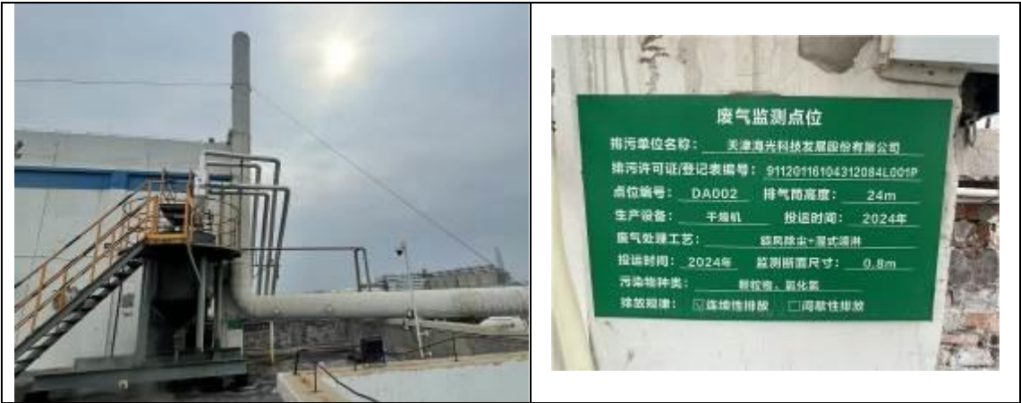
制药一车间氯化钠干燥废气排气筒 DA002
