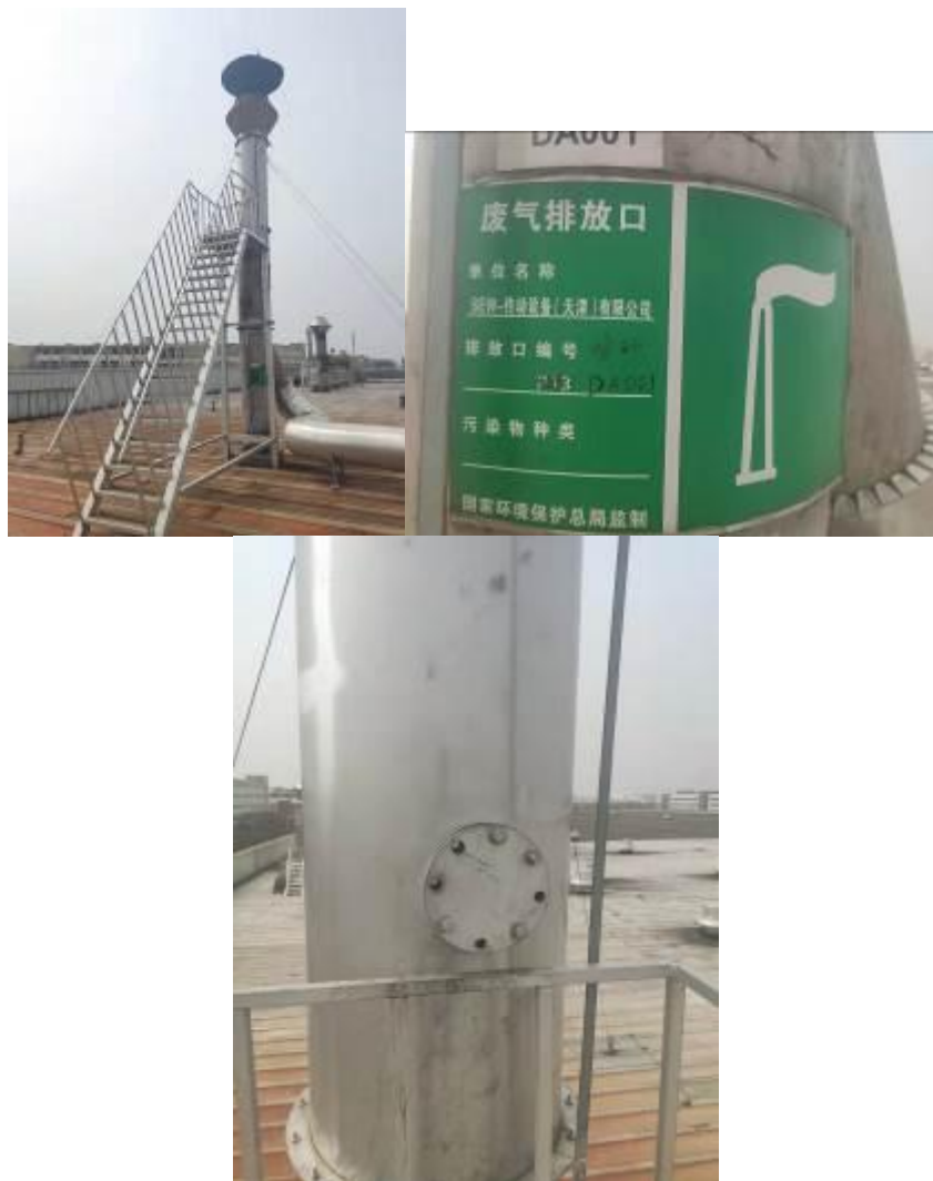
喷砂废气排气筒 DA001
