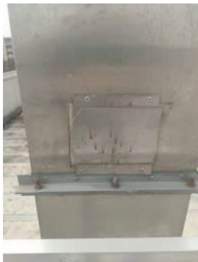
脱硫废气排气筒 DA006
