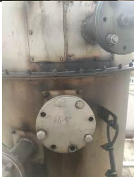
热处理炉窑废气排气筒 DA002
