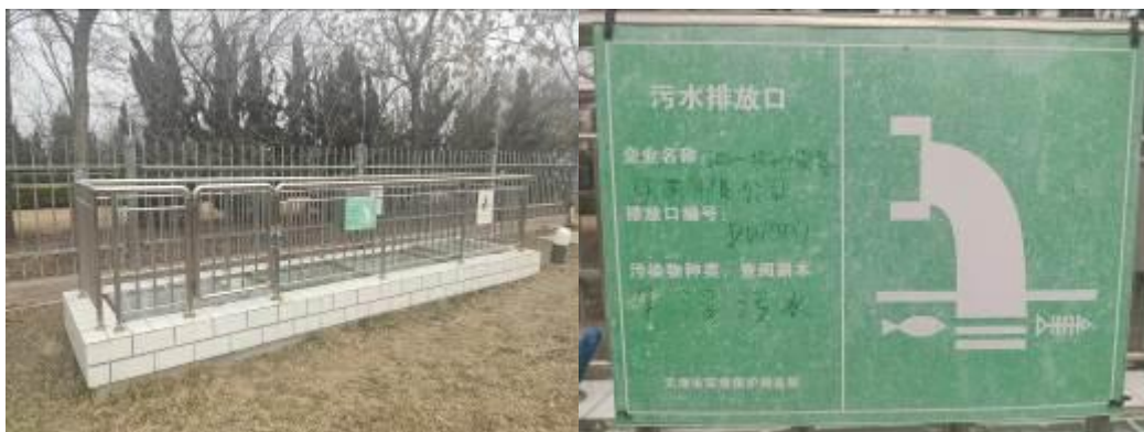
废水排放口 DW001
