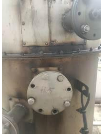
热处理炉窑废气排气筒 DA002
