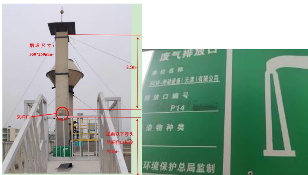
脱硫废气排气筒 DA006
