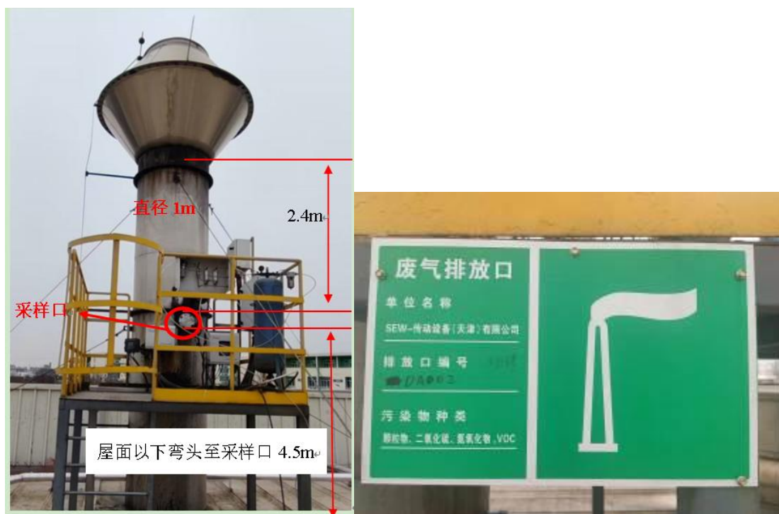
热处理废气排气筒 DA002
