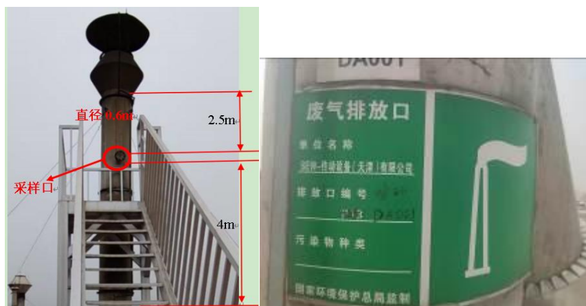
喷砂废气排气筒 DA001
