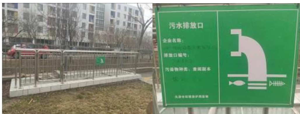
废水排放口 DW002
