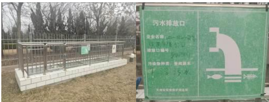
废水排放口 DW001
