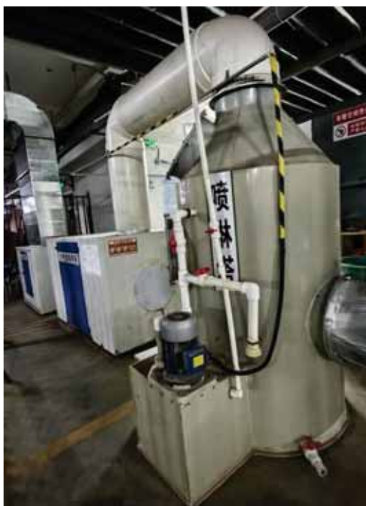
图 2.11-3 污水处理站废气治理设施（碱液喷淋塔+活性炭吸附箱）
