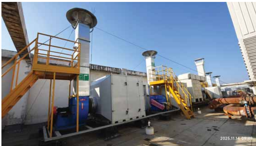
图 2.11-6 南区排气筒规范化设置情况
