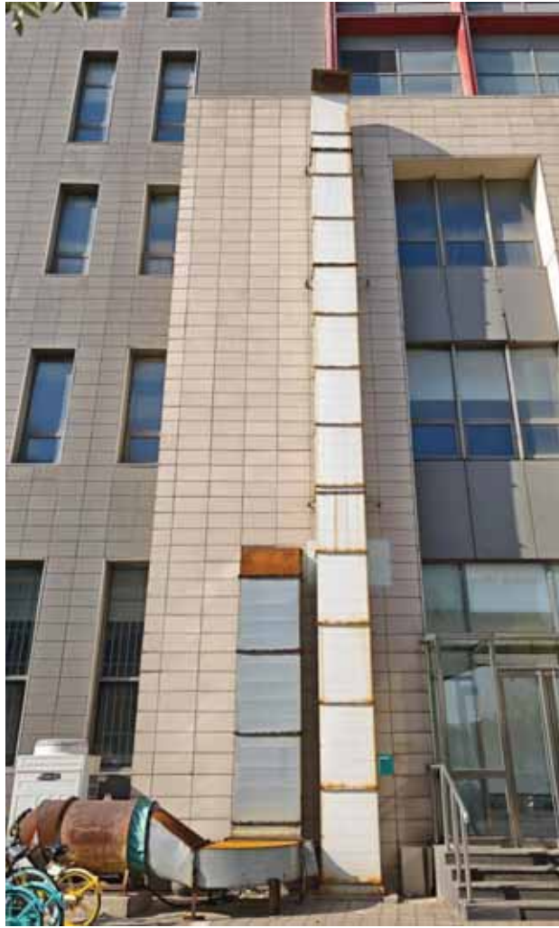
图 2.11-8 污水处理站废气排气筒规范化设置情况
