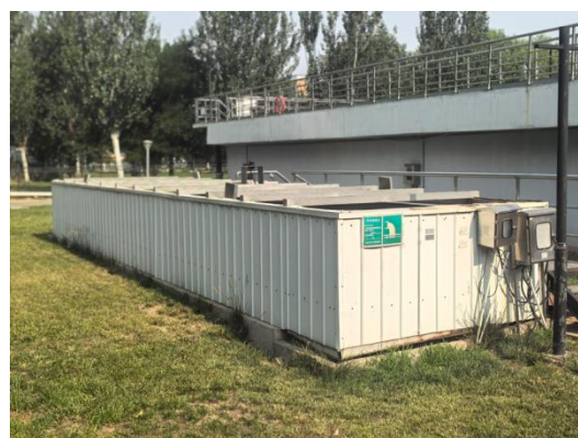
厂区污水总排口
