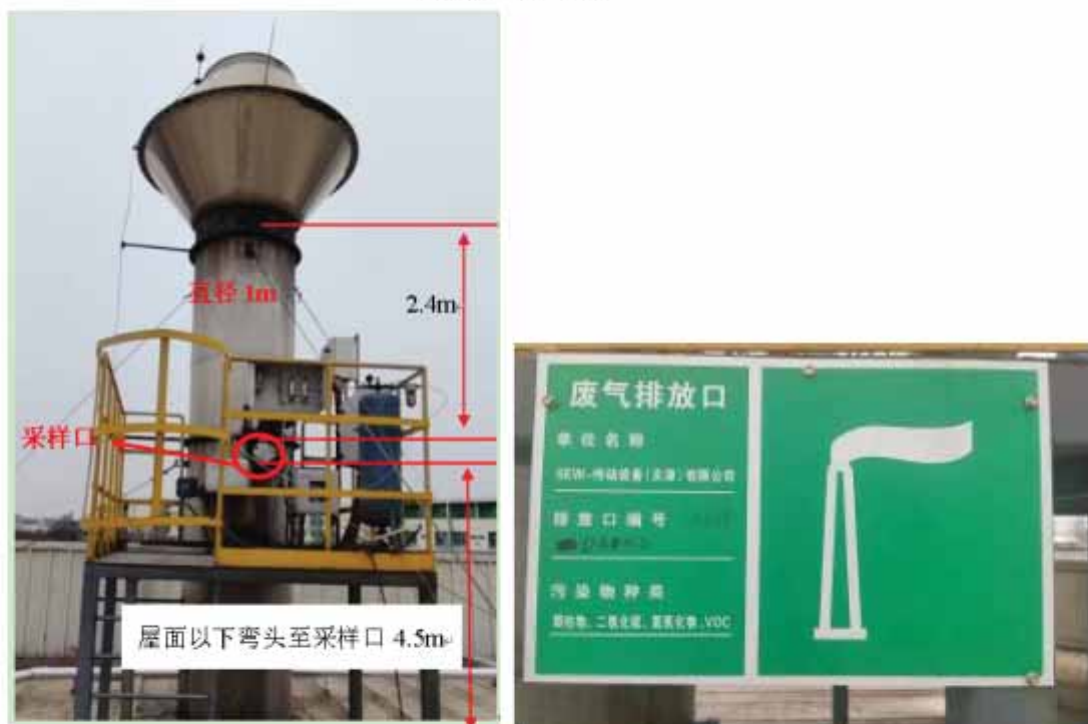
热处理废气排气筒 DA002
