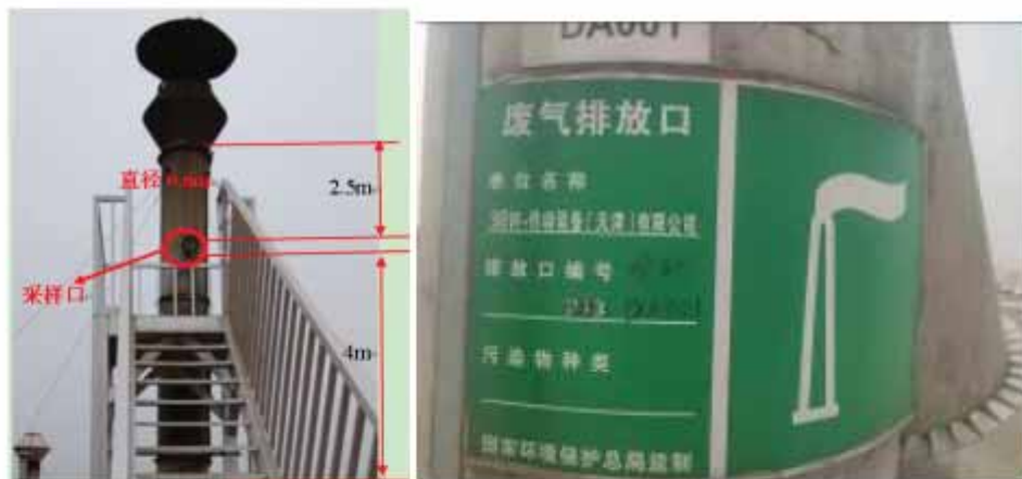
喷砂废气排气筒 DA001
