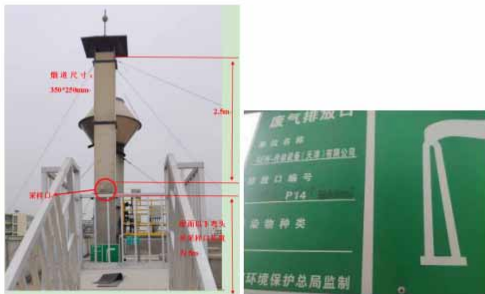
脱硫废气排气筒 DA006
