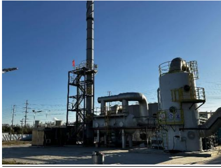
尾气综合治理 DA023 排气筒
