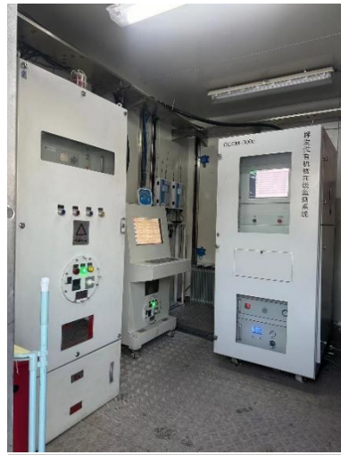
DA014 废气在线监测设施
