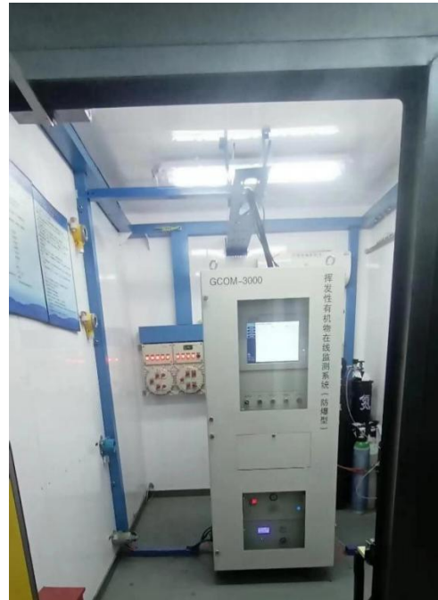
DA024 废气在线监测设施
