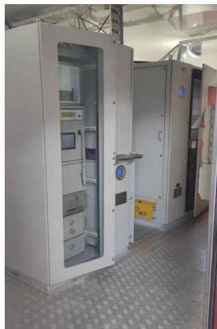
DA004 废气在线监测设施
