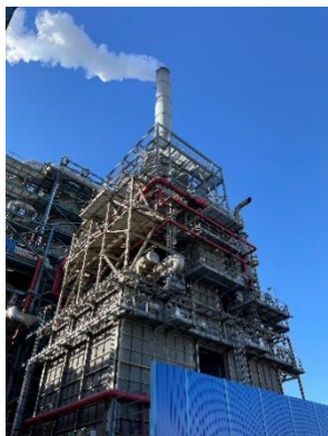
苯乙烯装置蒸汽过热炉 DA012 排气筒
