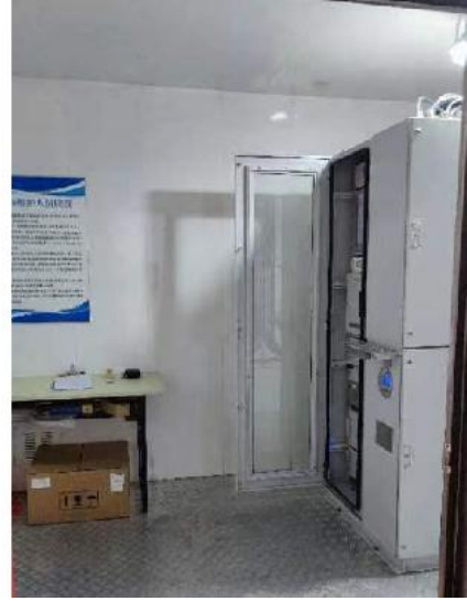
DA010 废气在线监测设施
