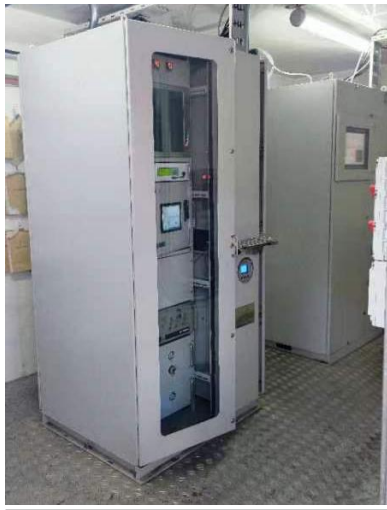
DA012 废气在线监测设施
