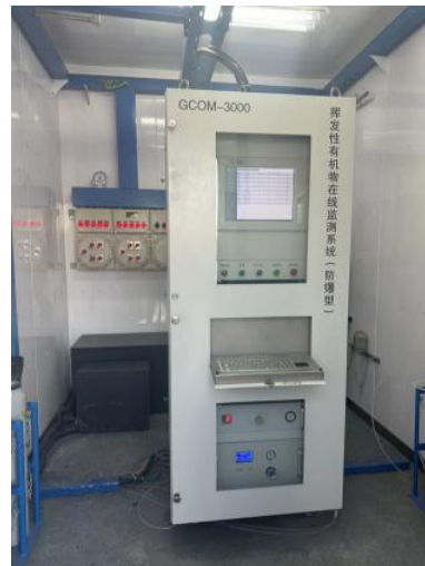
DA023 废气在线监测设施
