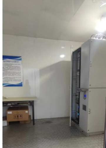
DA008 废气在线监测设施
