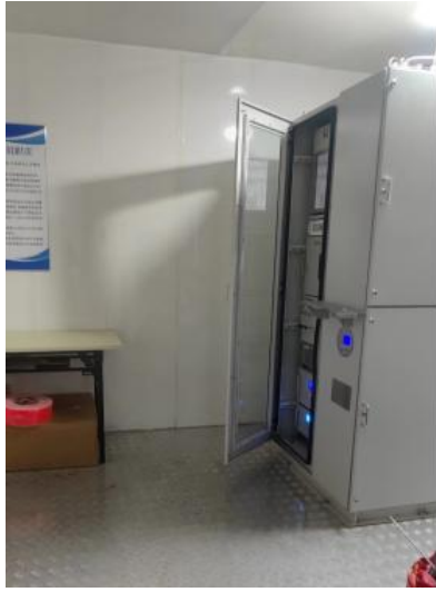
DA009 废气在线监测设施
