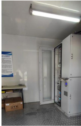
DA007 废气在线监测设施
