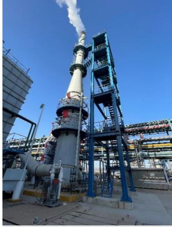
PBL 装置蓄热焚烧炉 DA004 排气筒
