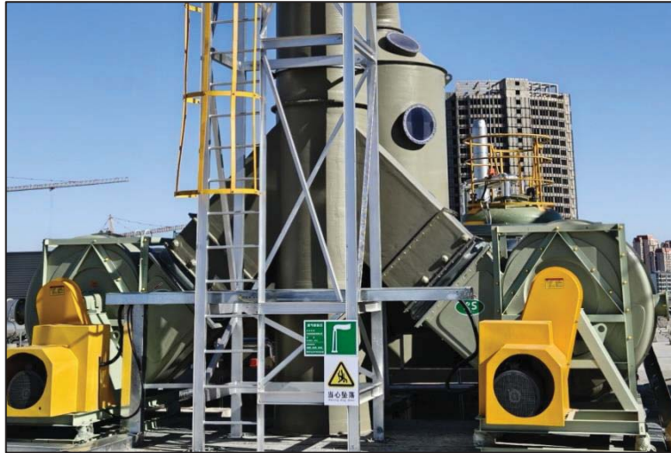
酸性废气处理设施
