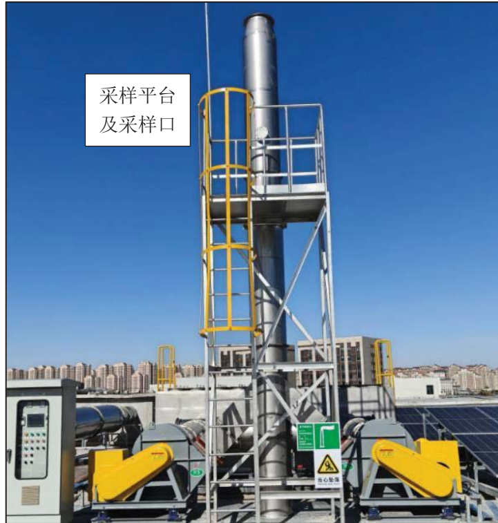
有机废气排气筒 (DA007)
