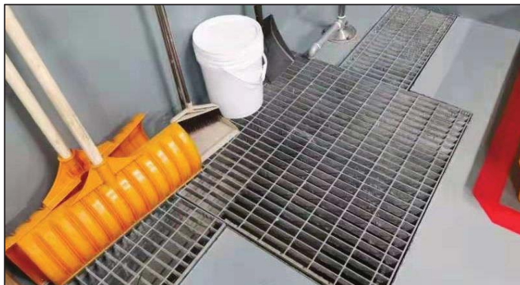
耗材供应车间内泄漏物料收集渠
