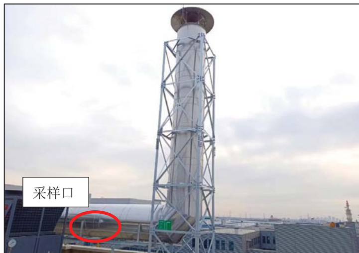
燃气锅炉排气筒 (DA004)
