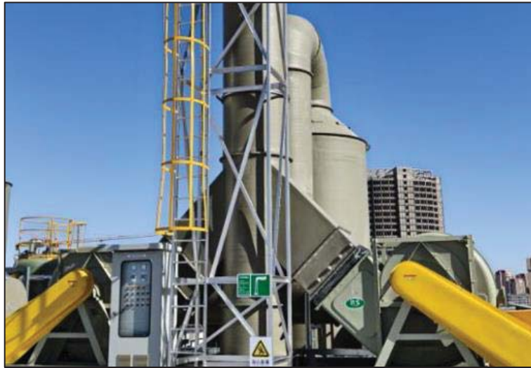
工艺废气处理设施
