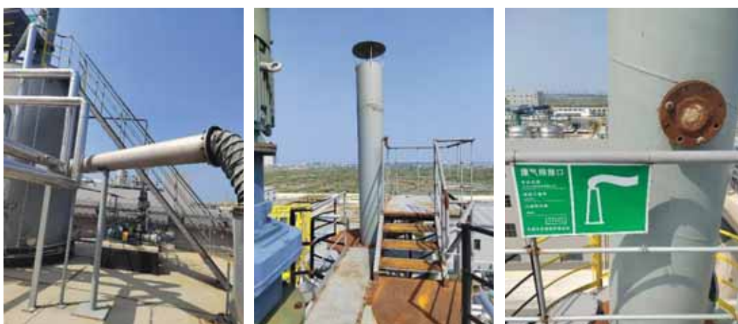
图 4.4-2 排气筒 DA004 规范化设置情况
