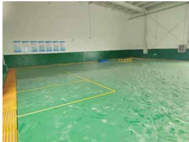
图 4.2-3 危废仓库地面防渗
