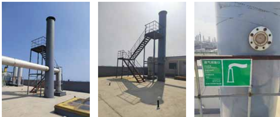
图 4.4-1 排气筒 DA012 规范化设置情况
