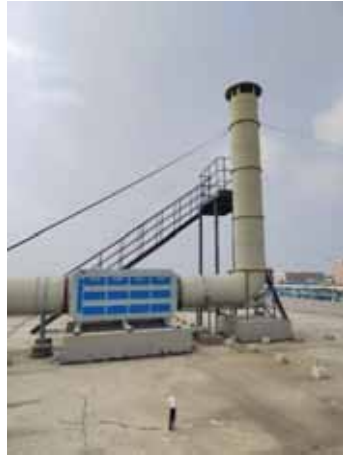
图 4.1-3 质检楼活性炭吸附装置
