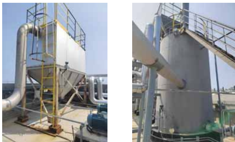
图 4.1-2 食品级甘氨酸车间袋式除尘器和水喷淋塔
