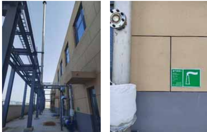
图 4.4-4 排气筒 DA005 规范化设置情况
