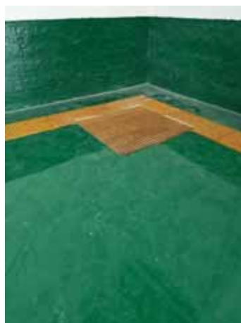
图 4.3-2 危废仓库泄漏液收集坑
