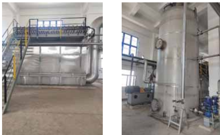
图 4.1-1 结晶干燥车间的袋式除尘器和水喷淋塔
