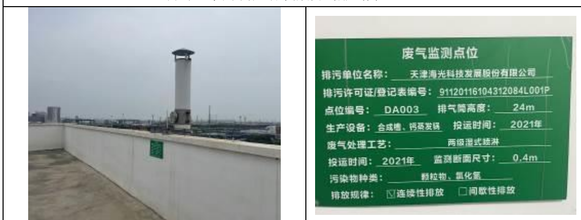
制药二车间氯化钙废气排气筒 DA003
