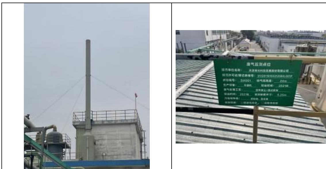
制药二车间干燥废气排气筒 DA001
