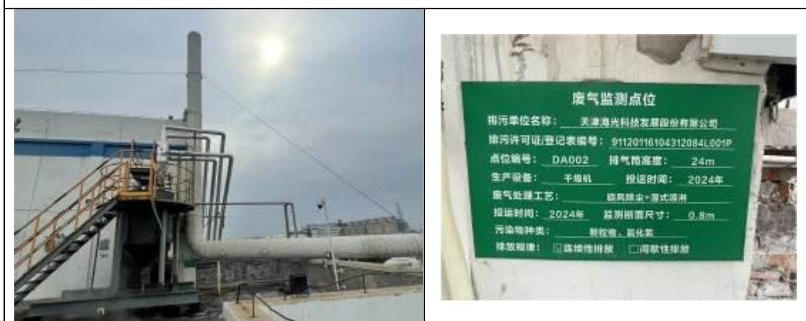
制药一车间氯化钠干燥废气排气筒 DA002
