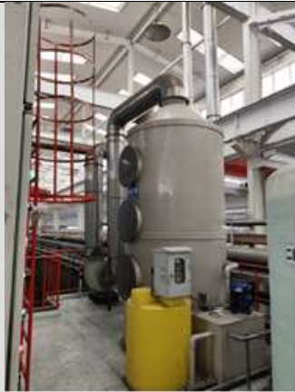
喷淋塔中和装置
