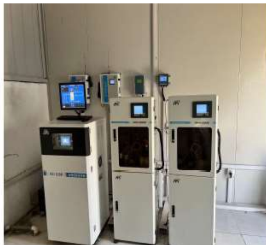
废水在线监测设施
