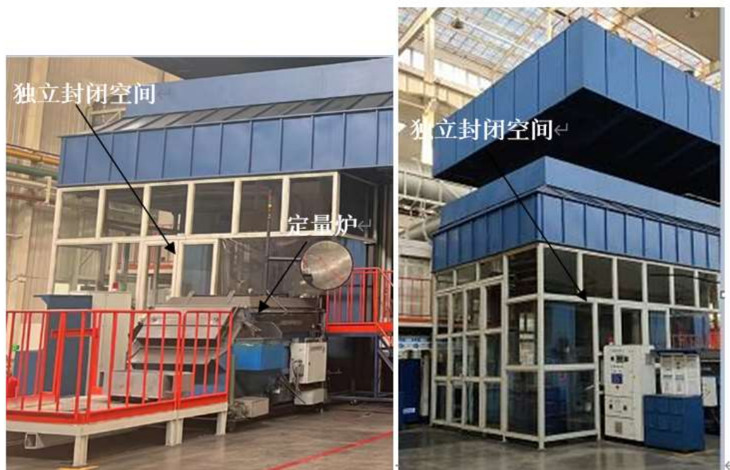
模具烘烤燃气废气、脱模剂有机废气收集装置
