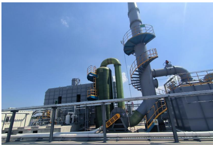
图 2.6-1 现有 RTO 装置照片
