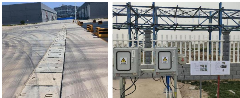
装卸站周边的集液沟
