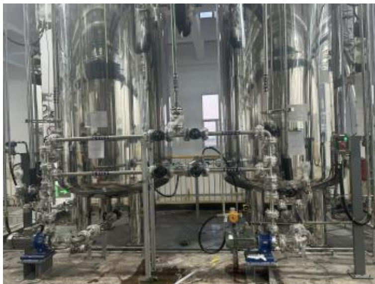
图 2.6-4 甲类厂房 A 内的可燃气体检测报警仪
