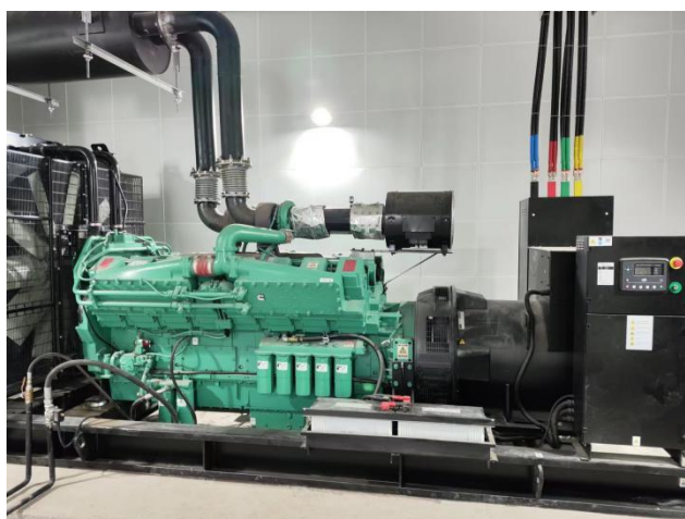
图 2.6-8 应急柴油发电机现场照片
