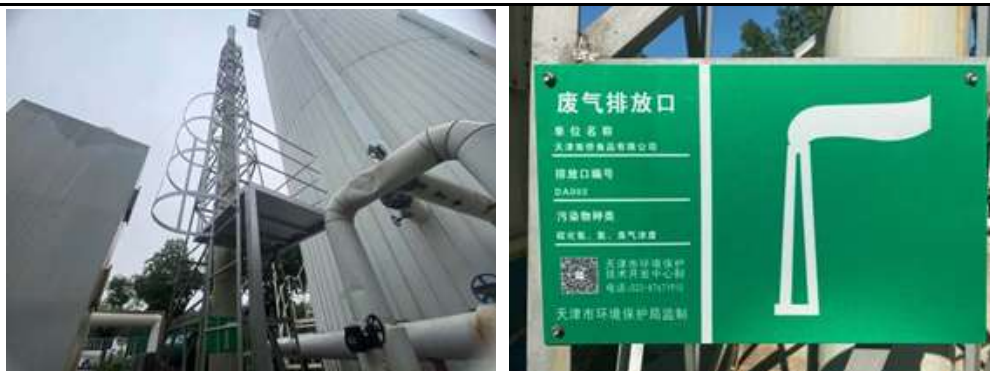
污水站废气排气筒（P 2 ）及标识牌
