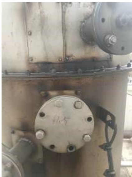
热处理炉窑废气排气筒 DA002
