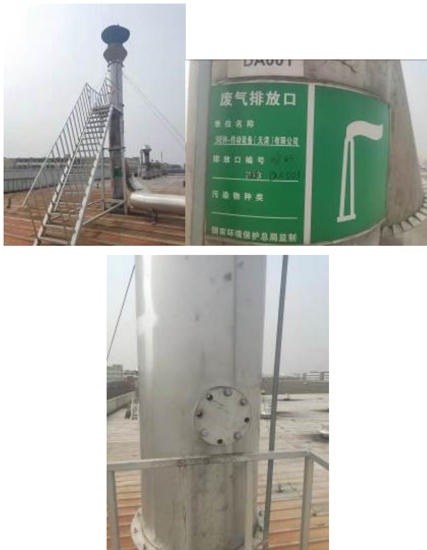
喷砂废气排气筒 DA001
