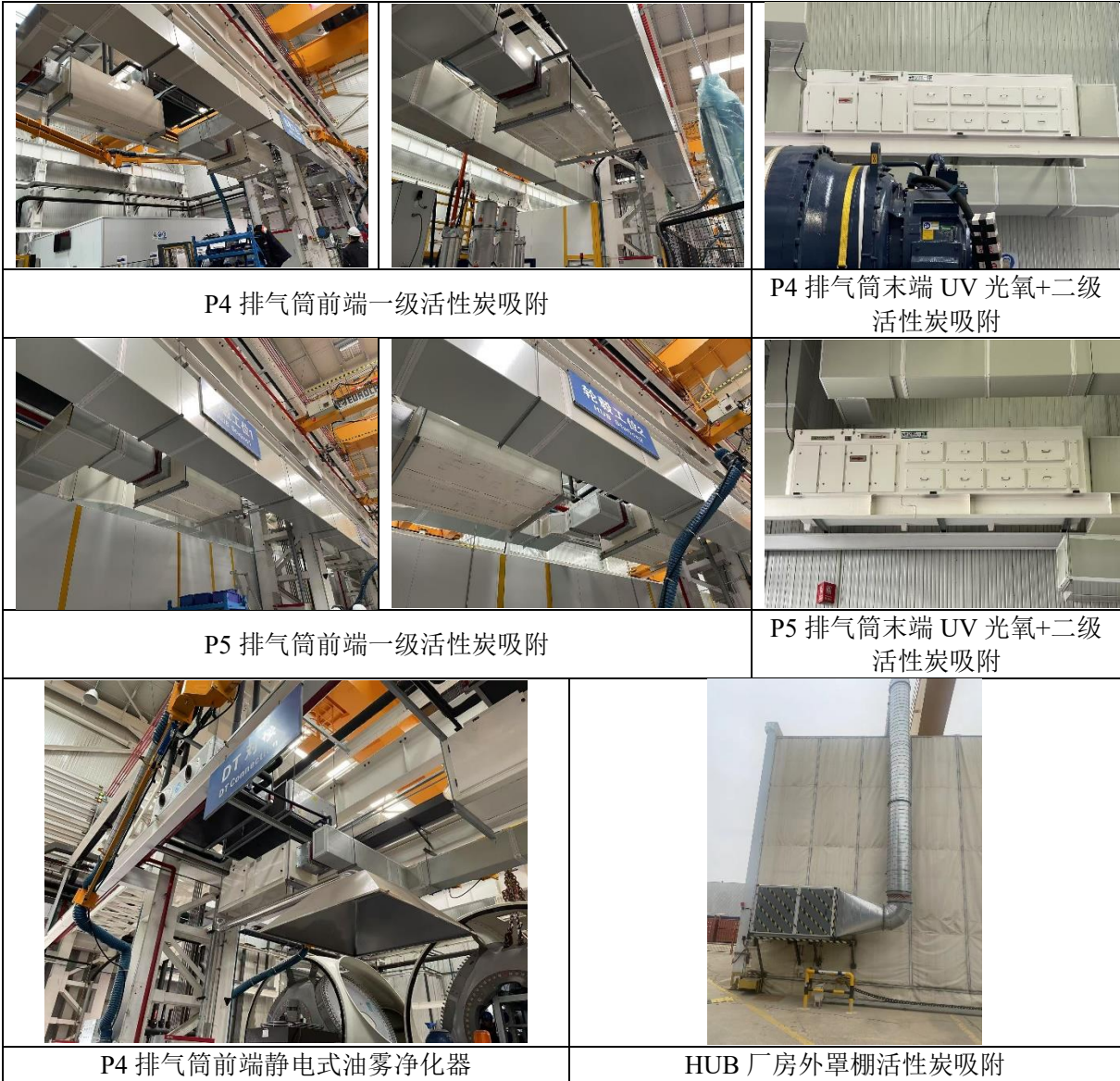
图 4-4 HUB 厂房废气处理设施
