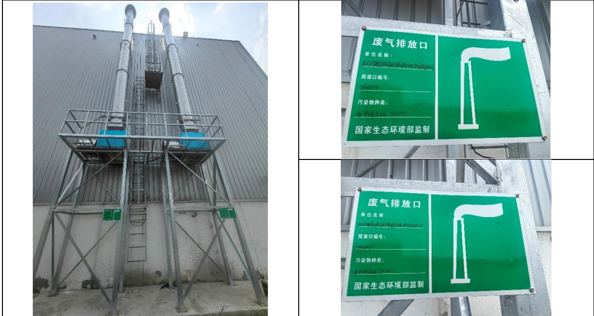
左侧为排气筒 P5（排污许可证编号为 DA004），右侧为排气筒 P4（排污许可证编号为 DA005）
