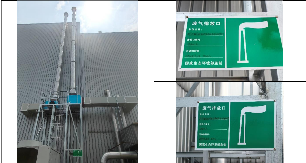
左侧为排气筒 P3（排污许可证编号为 DA002），右侧为排气筒 P1（排污许可证编号为 DA003）
