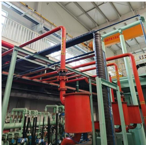
合金片炉自带的粉尘过滤器过滤
