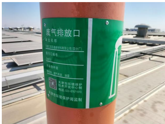
排气筒 P 10 规范化情况
