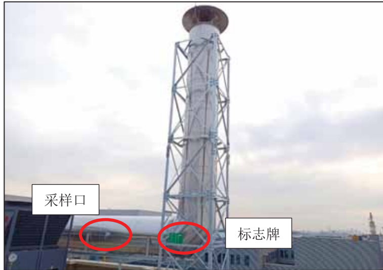
燃气锅炉排气筒 (P4)
