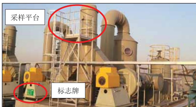
工艺废气排气筒 (P2)
