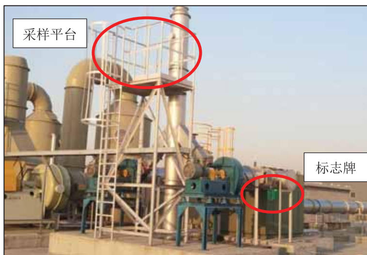
有机废气排气筒 (P3)
