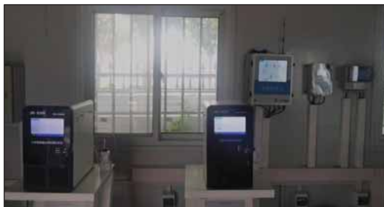
污水总排口 (DW001)
