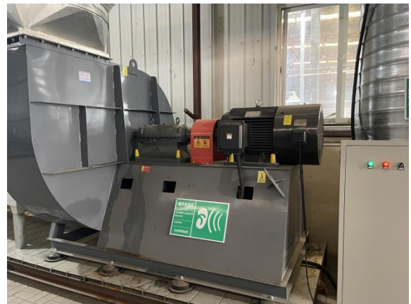
P2 排气筒风机 (55000m 3 /h)
