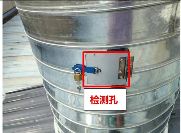
废气出口检测孔
