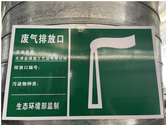
P2 排气筒标识牌
