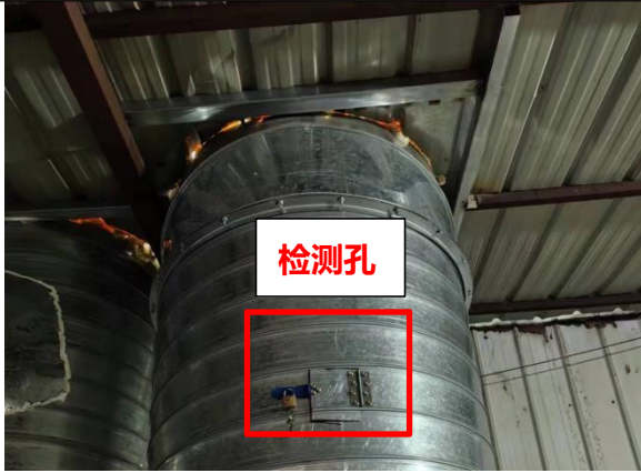
废气进口检测孔
