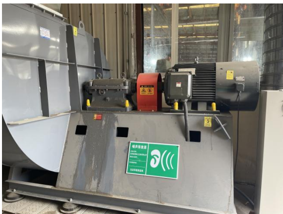
P3 排气筒风机 (55000m 3 /h)
