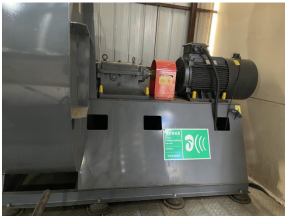
P1 排气筒风机 (55000m 3 /h)
