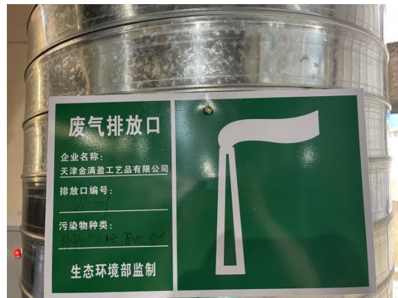
P1 排气筒标识牌
