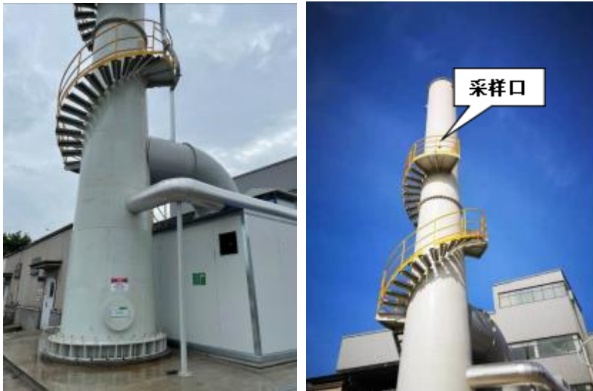
喷涂废有机气排气筒 (DA014)
