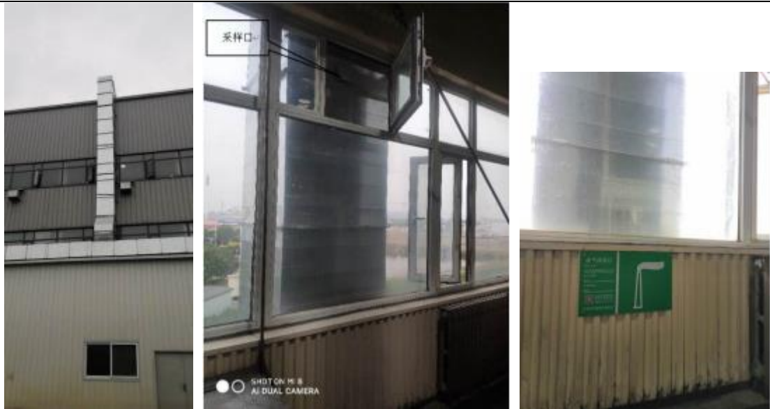
喷砂废气排放口 (DA013)
