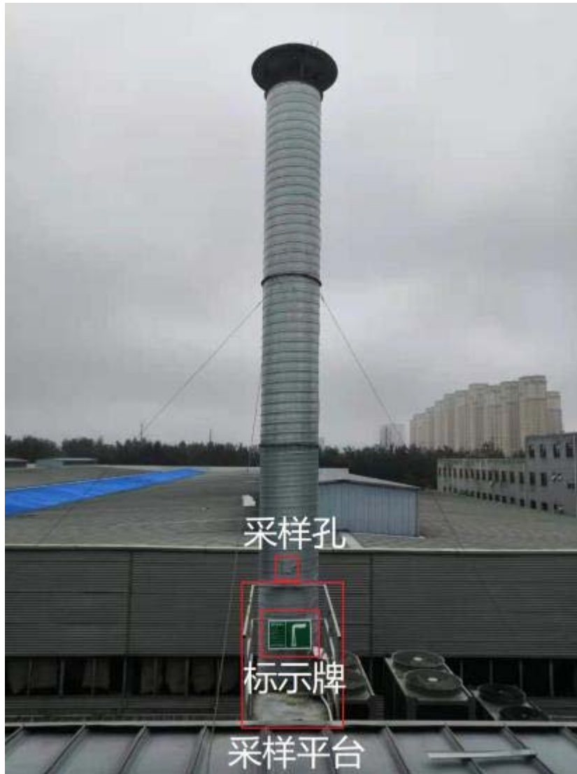
DA008 注塑、PUR 有机废气排气筒
