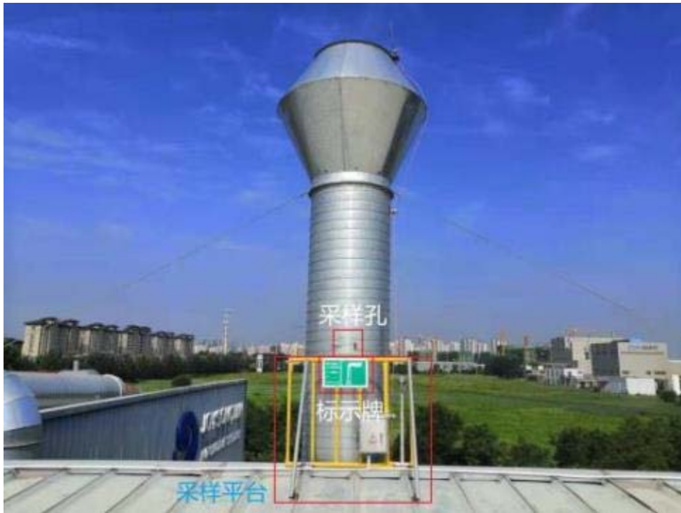
DA001 注塑、焊接、喷消音水废气排气筒
