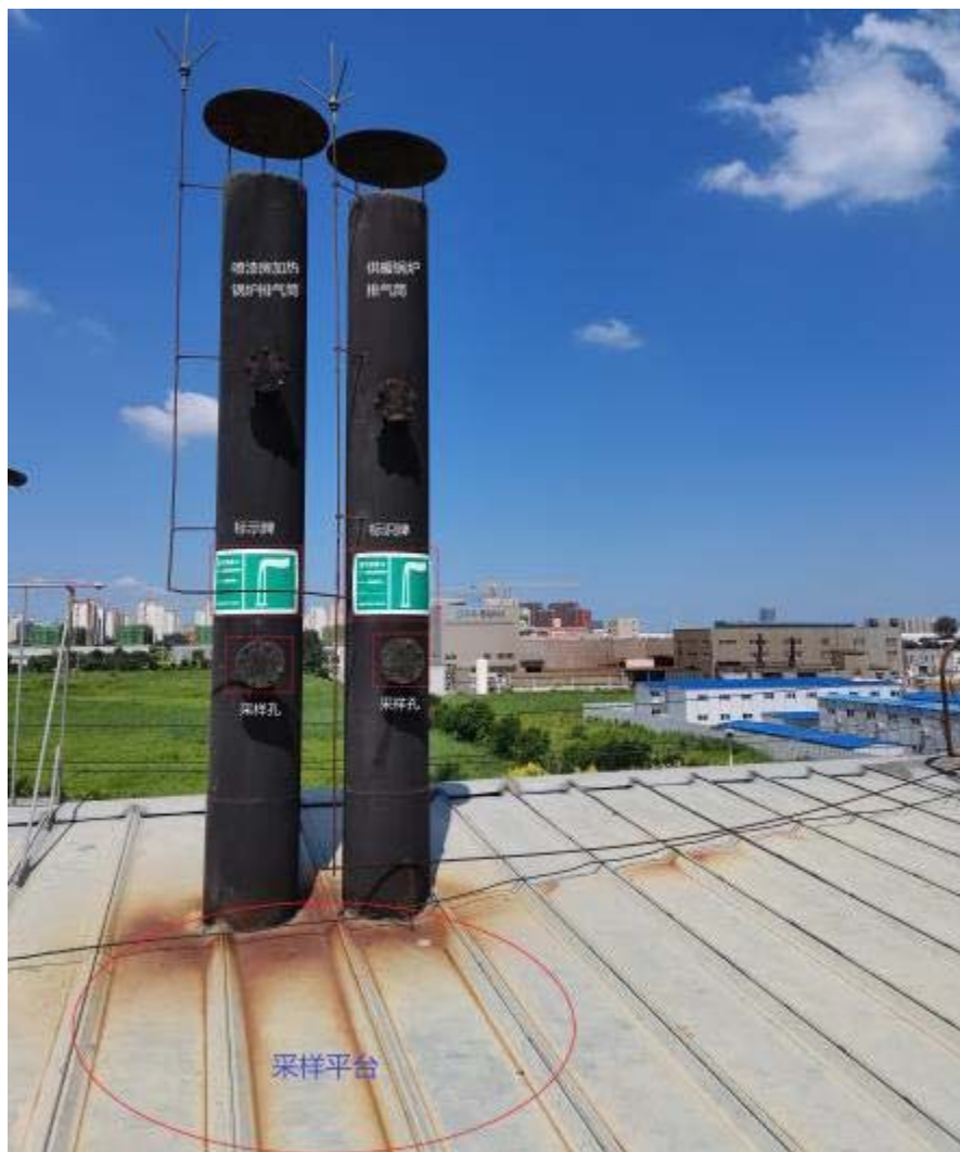
DA006 锅炉废气排气筒（右侧）、DA007 锅炉废气排气筒（左侧）
