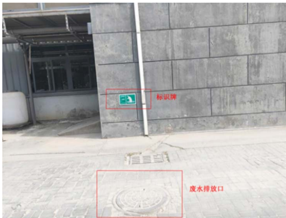
废水排放口 DW001
