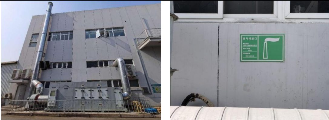
图2-11 清洗工序排气筒（DA004）及其标识牌
