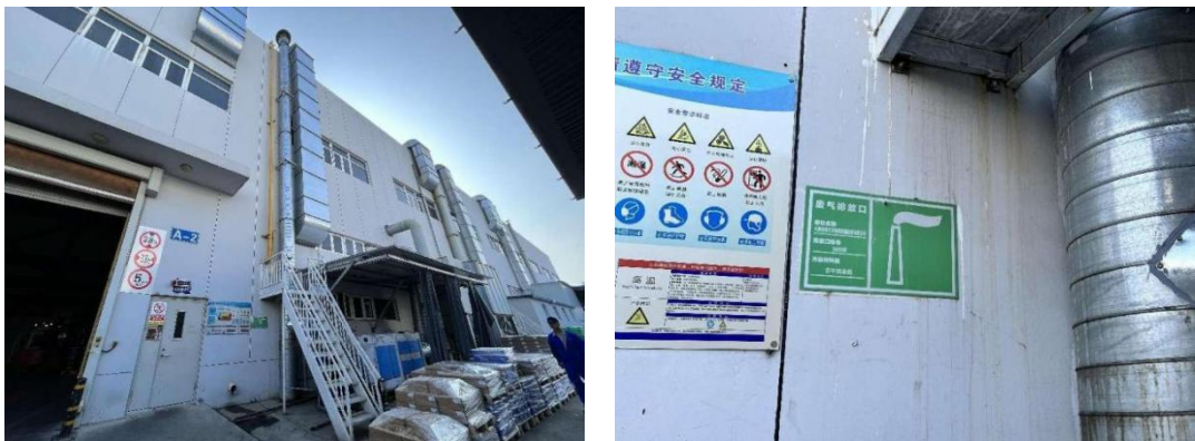
图2-9 压铸脱模工序排气筒 (DA002) 及其标识牌
