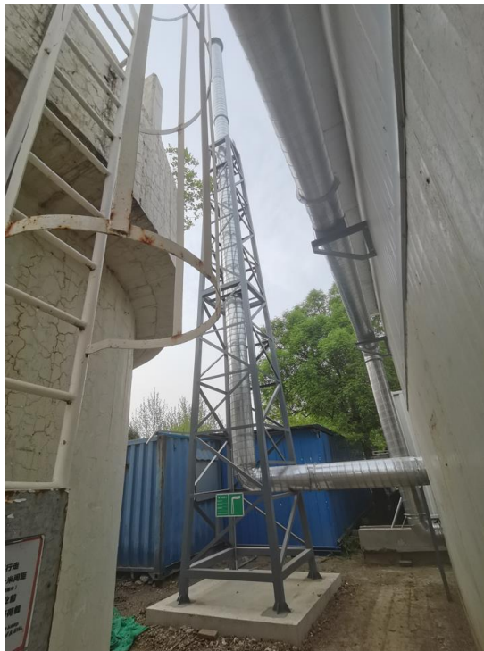
图 3-5 本项目污水处理站新增废气排放口规范化建设情况
