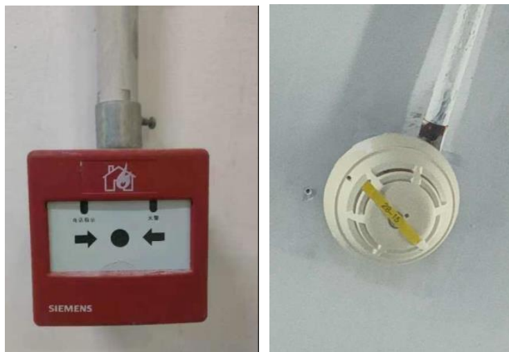
图 3-3 车间内火灾报警器装置照片
